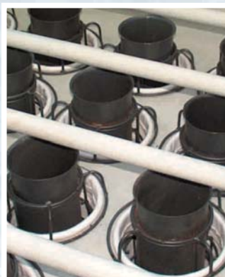
pohled do filtru
