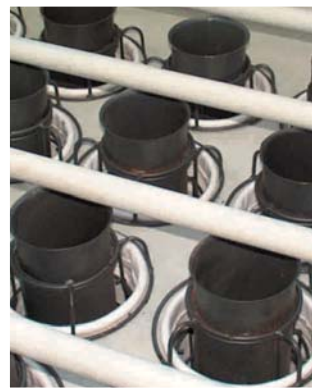
pohled do filtru
